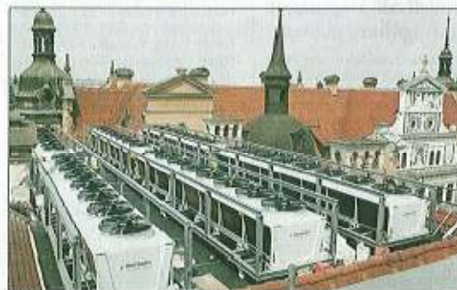
Die Wärmetauscher auf dem Dach sind nur von oben zu sehen.
