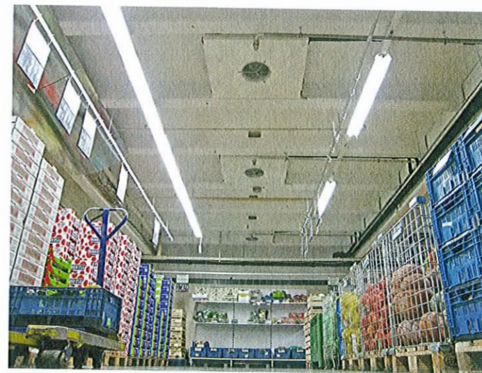
Aufgrund der geringen Raumhöhe und aus optischen Gründen mussten die eingesetzten Doppelblock-Deckenluftkühler (Typ: TBDR 040.1-1 Sonderausführung) zwischen den schmalen Betonunterzügen bündig auf Unterkante platziert werden
