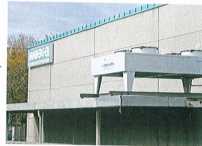
Die Kondensationswärme wird über einen luftgekühlten Axial-Verflüssiger Typ TCH 080.1-22-B-L (D5) von thermofin abgeführt
