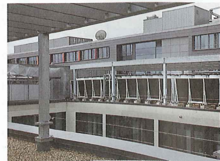
Insgesamt ist eine Kälteleistung von 2,8 MW erforderlich. Im Einsatz sind bisher drei Kaltwassersätze (2,1 MW), ein weiterer soll noch installiert werden
