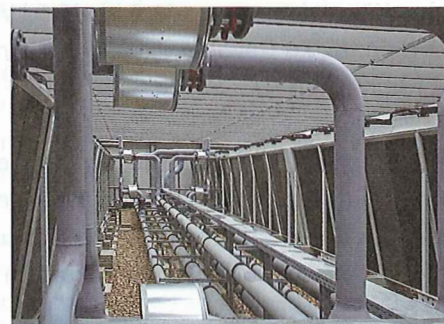
Nach Fertigstellung der DWD-Zentrale werden insgesamt zwölf Rückkühlwerke vom Typ „TDD 089.1-25-L (EC) B5-4P“ im Einsatz sein
