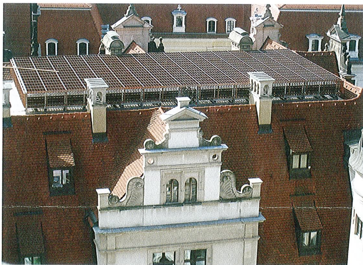
Im Endzustand sind die Rückkühler durch die Rasterblenden aus Kupferblech nicht mehr zu sehen
