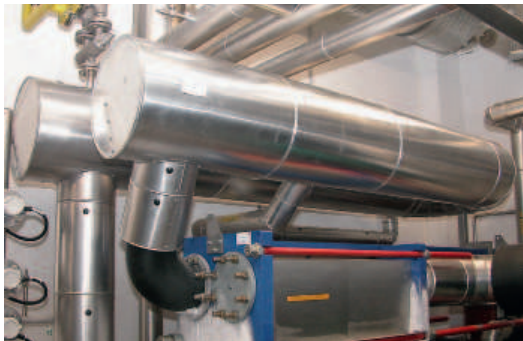
Der eingebaute U-Rohr-Flüssigkeitsabscheider mit Isolation
