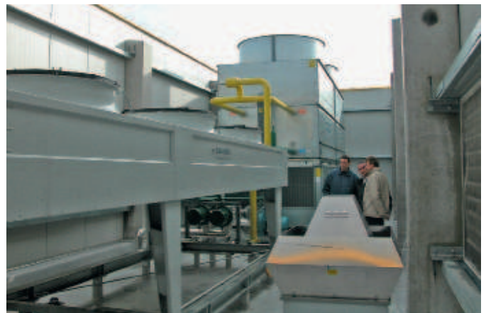
Auf dem dach des Maschinenraums sind der Trockenverflüssiger (Thermofin) und der Verdunstungsverflüssiger (Evapco, im Bildhintergrund) aufgestellt, beide mit geräuscharmen Axialventilatoren (maximaler Schalldruckpegel 85 dB(A))
