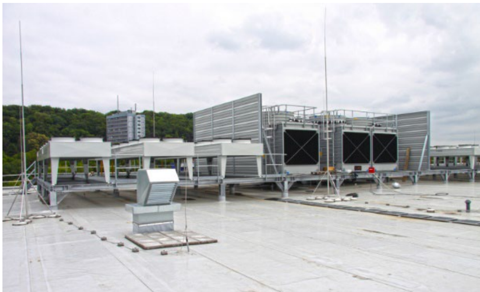
Verflüssiger auf dem Dach des Lindt-Werks (C. Brauneis)
