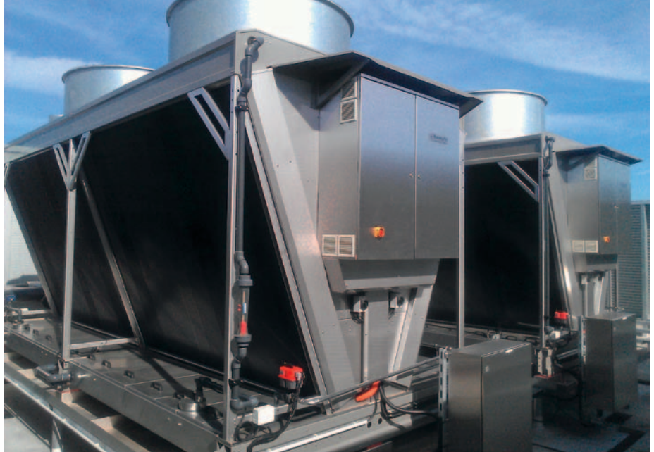
Bei der Hybriden Rückkühlung werden Nass- und Trockenkühlung in einem Gerät vereint.
