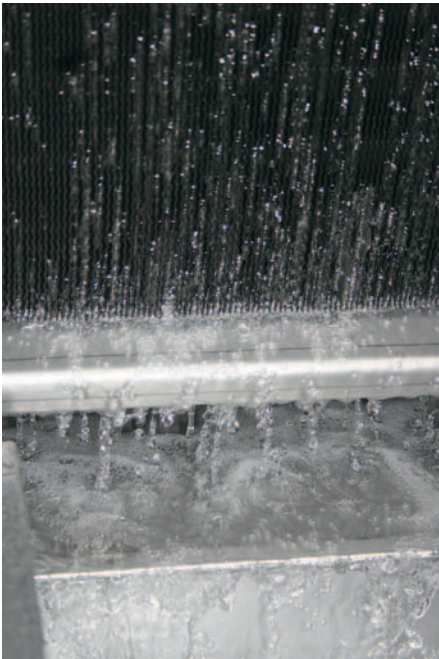
Um Salzablagerungen weitestgehend vorzubeugen und Korrosionsschäden auszuschließen, sollte der Wasserqualität eine hohe Beachtung geschenkt werden.
