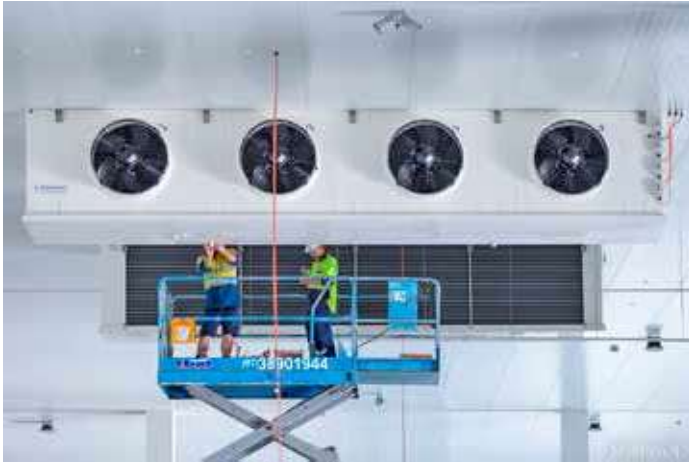
Bild 7: Installation von Bereitstellungsbereichsverdampfern mit einer Kühlerleistung von 140 kW
