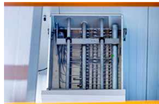
Bild 4: Tankverteiler für TK-Verdampfer
