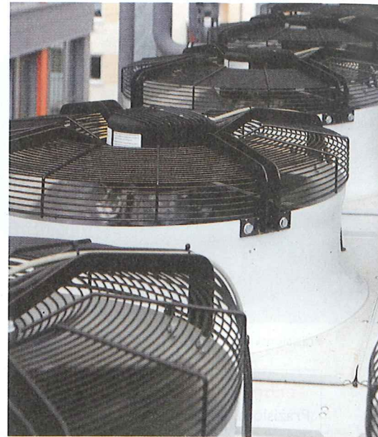
80 große EC-Axialventilatoren von ebm-papst sorgen auf dem Dach für die notwendige Rückkühlung
