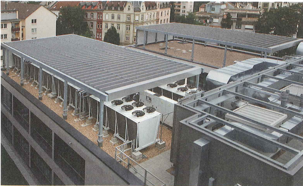
Die neu gebaute Zentrale des DWD liegt in einem Offenbacher Wohngebiet. Die Rückkühlanlage auf dem Dach muss daher neben höchsten Ansprüchen an Betriebssicherheit und Energieeffizienz auch strenge schallschutztechnische Anforderungen erfüllen
