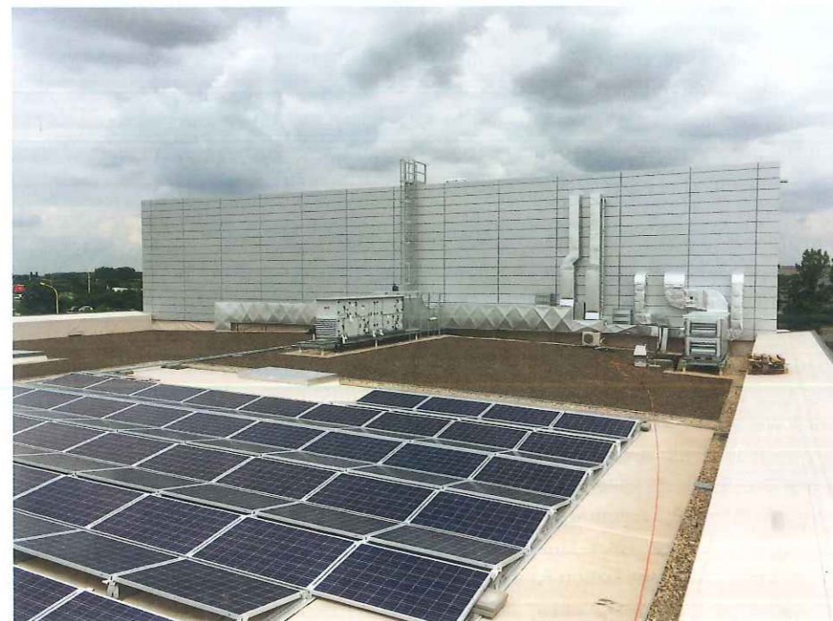
Abb. 9: Die auf dem Dach befindliche Photovoltaik-Anlage mit 150 kWp zur Bedeckung des Energiebedarfs der Kälteerzeugung bei entsprechender Witterung
