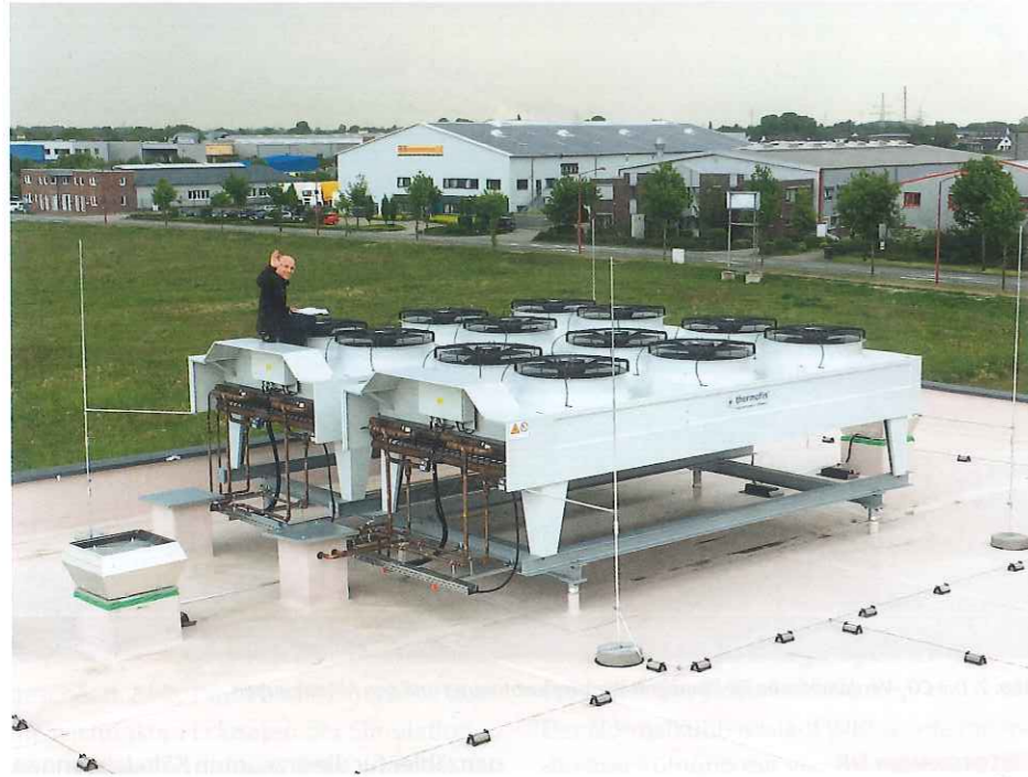
Abb. 8: Die beiden zweikreisigen, auf geringe Temperatur-Spreizung ausgelegten Verflüssiger mit großer Fläche und mit einem gut gelaunten Mitarbeiter
