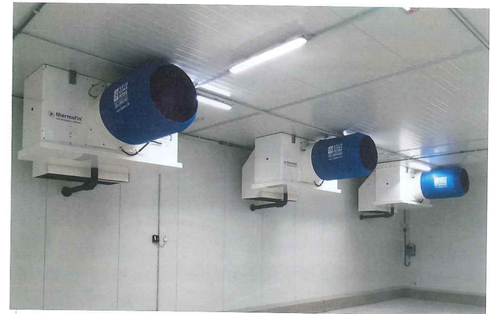
Abb. 7: Die CO 2 -Verdampfer im TK-Raum mit Warmsoleabtauung und den Abtauhauben
